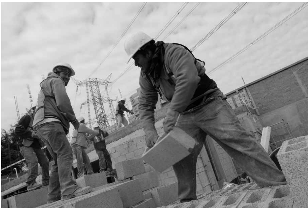
OCTAVIO HOYOS ▶ Trabajadores de la construcción erigen lo que será un sitio de descanso en la carretera México-Cuernavaca. Parres, Ciudad de México, 11 de diciembre de 2015.
