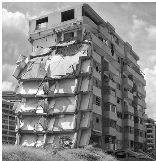
Edificio colapsado e invadido en la urbanización Los Corales, estado Vargas, Venezuela, luego de los aludes de diciembre de 1999. En 2007 el edificio fue desalojado por las autoridades.
