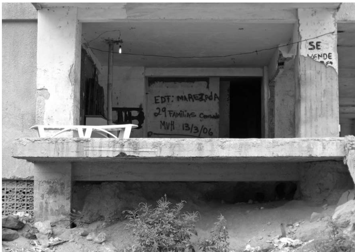
Edificio Marejada, en Los Corales, estado Vargas, Venezuela, en su situación actual, luego de los efectos de los aludes de diciembre de 1999. Este edificio no ha sido desalojado hasta el presente.
