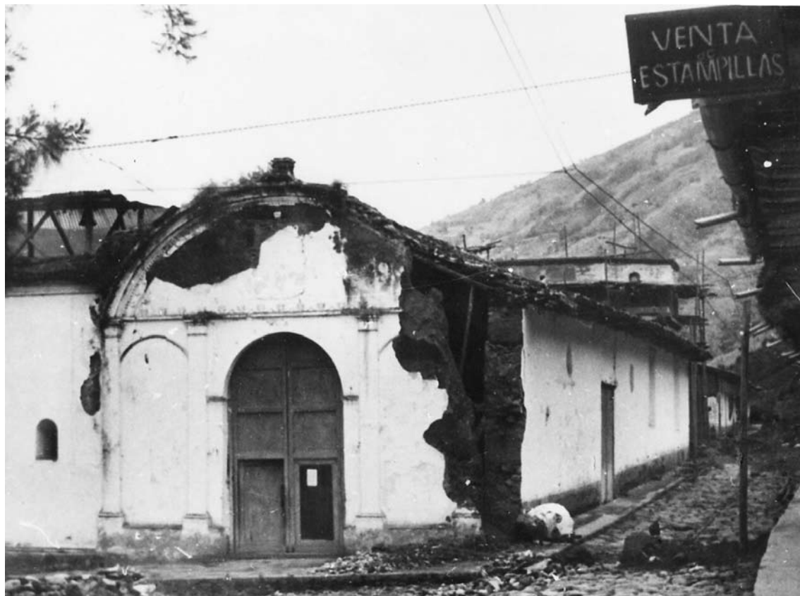
Daños causados en la iglesia de Aricagua, población ubicada en la cordillera nevada de los Andes venezolanos, al sur de Mérida, luego del sismo del 30 de junio de 1959.
