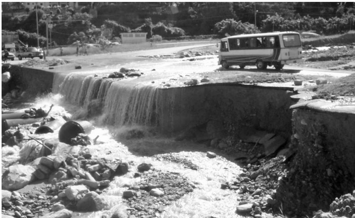
Daños en las vías causados por las lluvias de febrero de 2005 en el estado Vargas, Venezuela.
