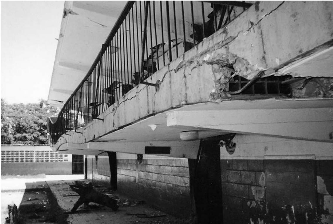
Colapso de la escuela Valentín Valiente con el sismo del 9 de julio de 1997 en la localidad de Cariaco, al oriente de Venezuela.
