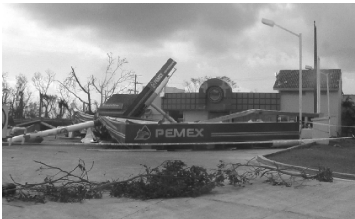
Figura 7. Los fuertes vientos del huracán provocaron el colapso de la gasolinera en Puerto Aventuras.
